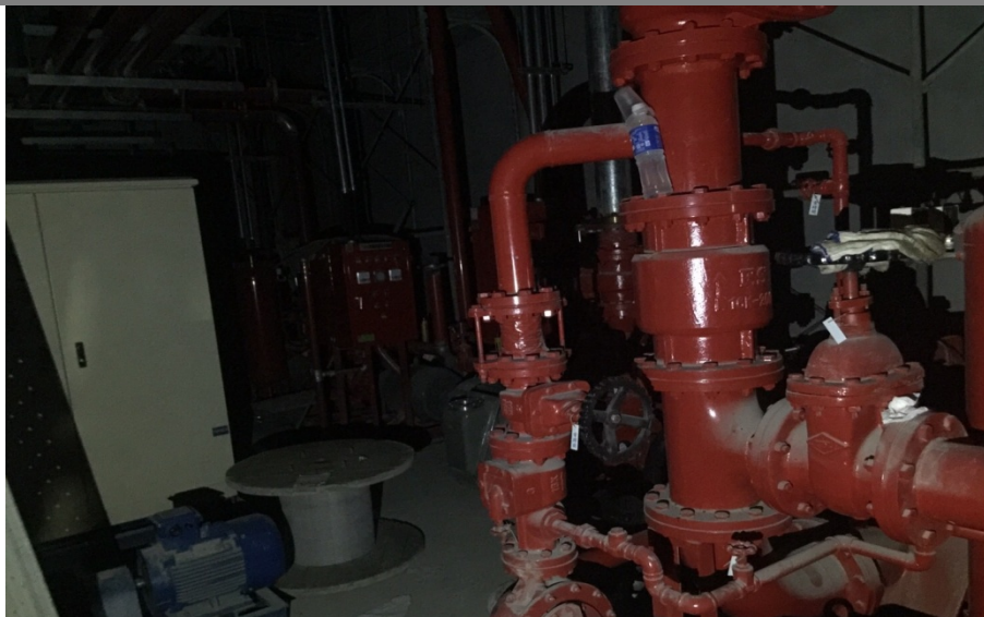
消防泵浦設備
