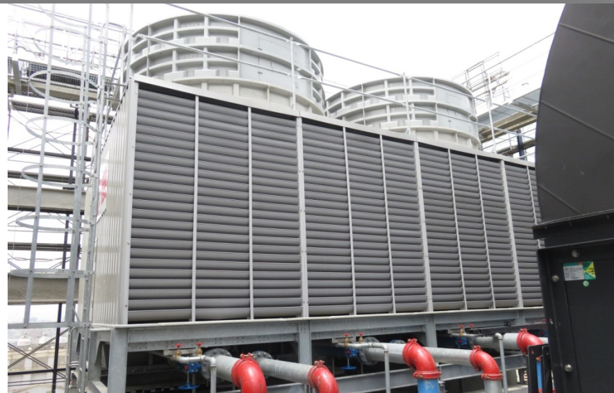
空調冷卻水塔
