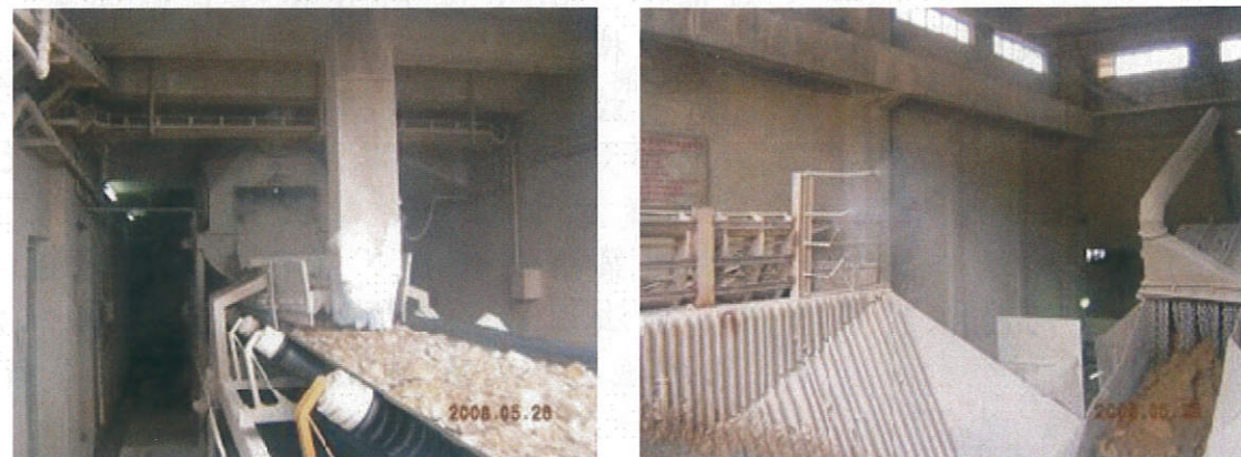
圖 29、局部集氣系統及自動灑水設施
