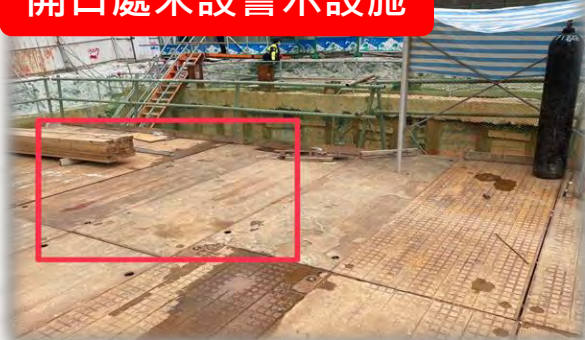
開口處未設警示設施
