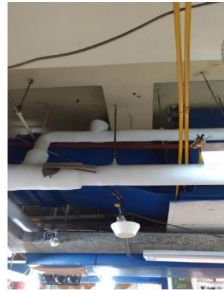
管線佈設壓迫空間淨高
