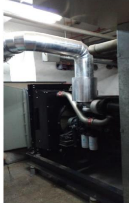
緊急發電機(300KW)
