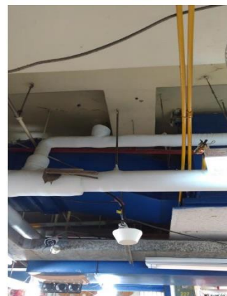
管線佈設壓迫空間淨高
