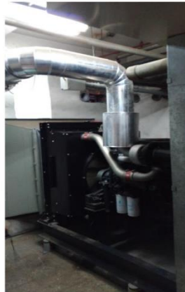
緊急發電機(300KW)
